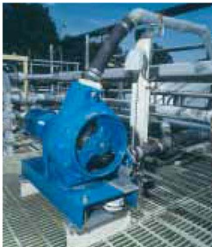
Pompe Z en neutralisation d'effluents
